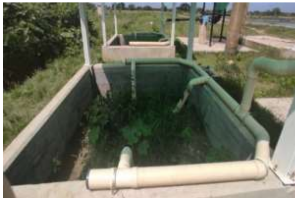
Evaluación del PSMV del municipio de Campo de la Cruz. Dos módulos de lecho de secado de arenas provenientes de los desarenadores. Lugar: EDAR Campo de la Cruz. Fecha: 17 de junio de 2021.
