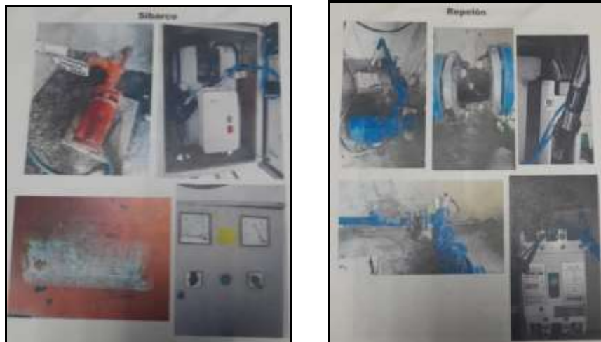
Mantenimiento Motobombas en las diferentes sedes.
